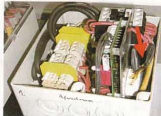
Bild 4: Kurzschluss an der Leiterplatte einer elektronischen Strombegrenzung
